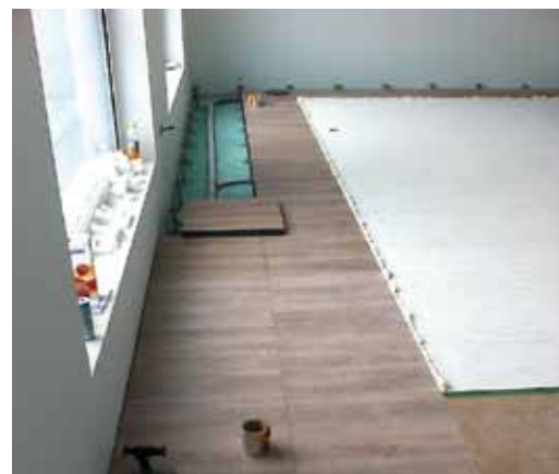
Neubau bei Elektro Stadler: Das Besondere hier ist die Kombination eines beheizten Hohlbodens mit einem Doppelbodenkanal, auf denen ein Design-PVC-Belag verbaut wurde
