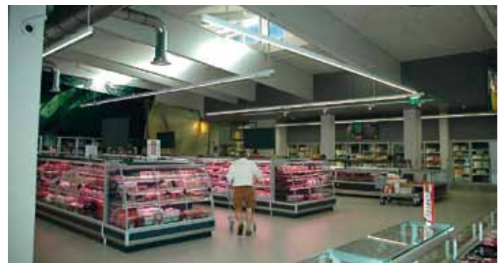
Auch Notleuchten, Brandmelder, Lautsprecher und eine 3-Phasen-Stromschiene konnten in das Tragsystem integriert werden
